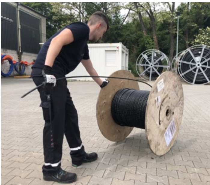
Über 180 km der modernen Glasfaserkabel wurden bereits in Mainz und der Region verlegt.
