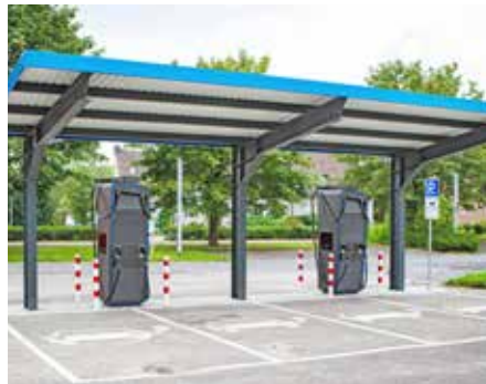
Zwei Hypercharger mit je 150 kW Ladeleistung mit PV-Dach für Eigeneinspeisung in Dülmen.
