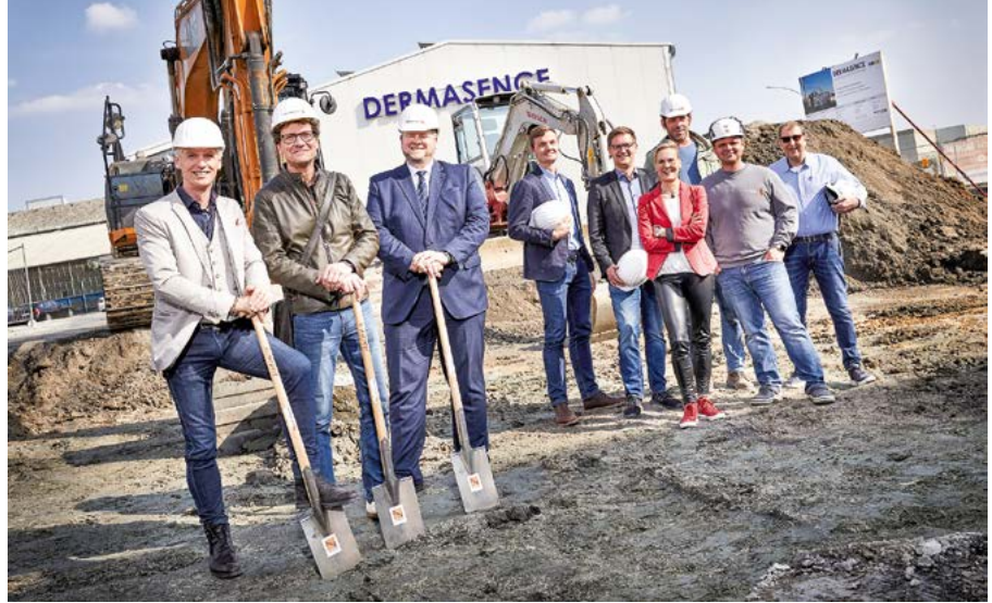
Erster Spatenstich: (v.l.) Detlef Isermann, Architekt Hans-Jürgen Schulte, Wirtschaftsförderer Enno Fuchs, Philipp Beckmann (Dermasence), Jens Aupers (Aupers Ingenieure), Gudrun Hams-Weinecke (Dermasence), Bauleiter Stephan Strodmeier und Polier Lukas Drabik (Nabe Hoch- und Tiefbau) sowie Michael Beckmann (Dermasence). Foto: Andreas Löchte
