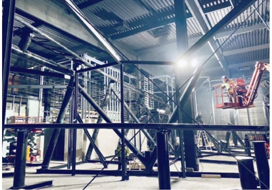
Der Bau der „Movie Park Studio Tour“ war aufgrund der engen Platzverhältnisse und der Zeit eine Herausforderung.
