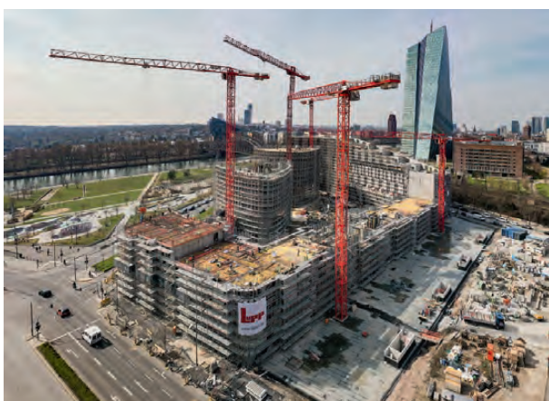
Die Dimensionen der heutigen Großbaustellen wie hier in Frankfurt lassen sich nur per Luftaufnahme erahnen.
