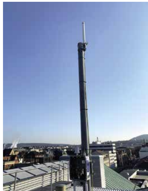
LoRaWAN-Gateway auf dem ehemaligen Gebäude der RhönEnergie Fulda in der Bahnhofstraße
