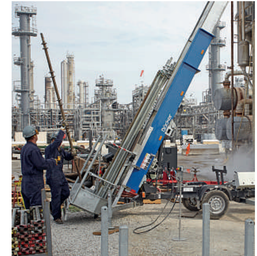
Der Böcker Gerüstaufzug Junior G HD 24 im Einsatz.
