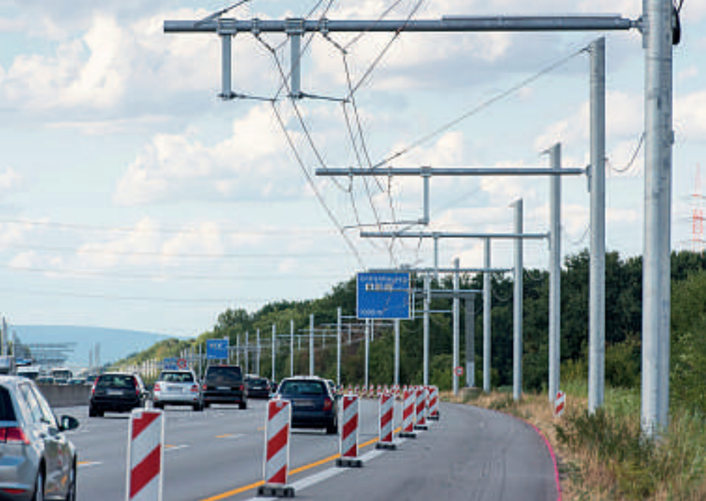
Versuchsstrecke mit Oberleitung („E-Highway“) bei Darmstadt. Foto: digitalstock / Adobe Stock
