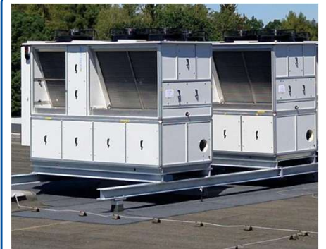
Wärmeversorgung durch Wärmepumpen
