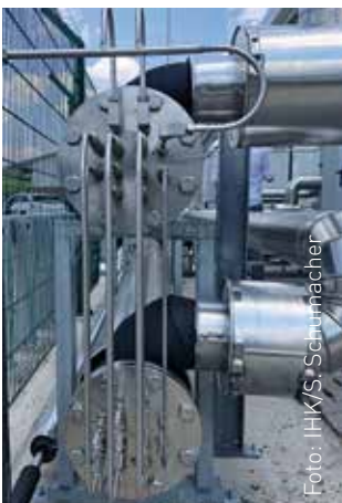
Wasserstoffrohre: Hier in der Anlage des Grünen H2-Hub der CEC Haren GmbH & Co. KG in Haren (Ems).
