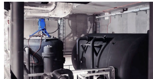
Georg-August-Universität Göttingen I+II FLÜSSIGESPEICHERSYSTEM ZUR KÄLTEVERSORGUNG
