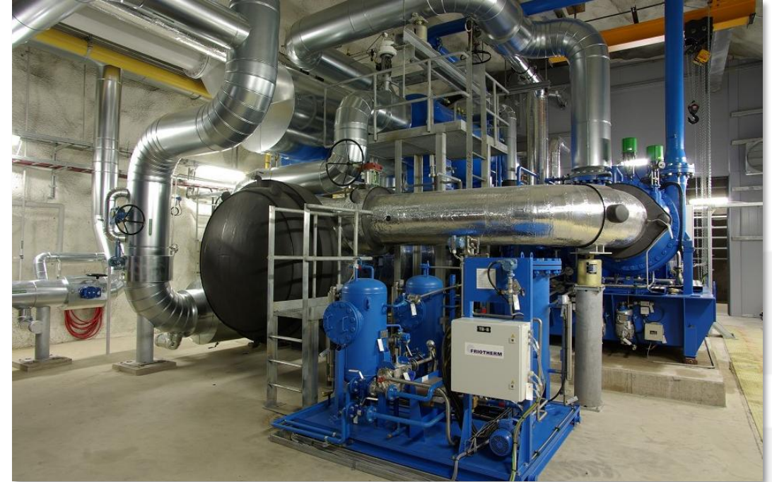
Wärmepumpe 20.000 kW = 20 MW
