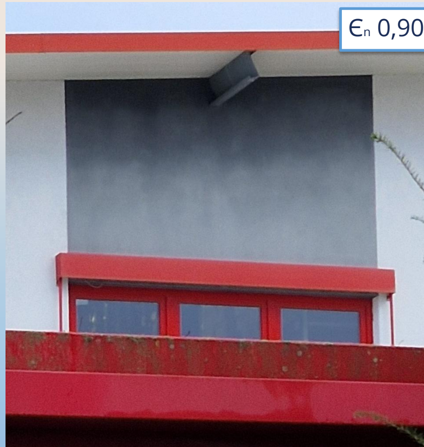
Fachada sin MIG-ESP después de 3 años
