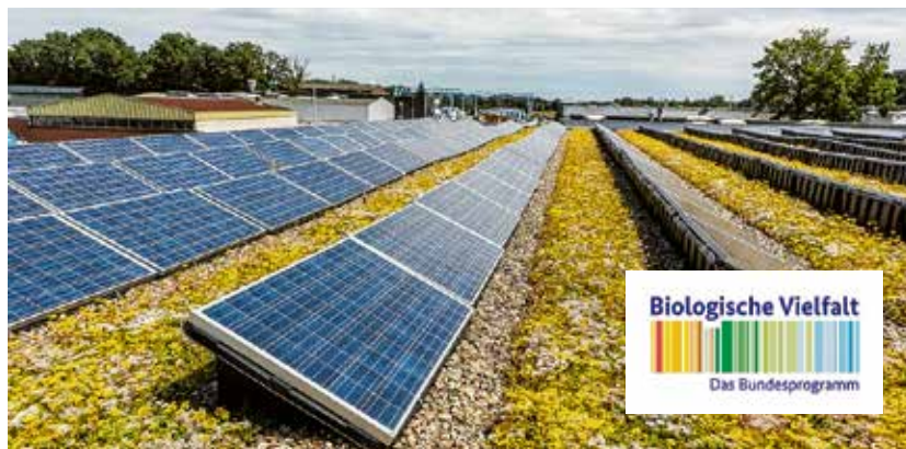
Begrünte Photovoltaikanlage. Foto: Sebastian Hoehn
