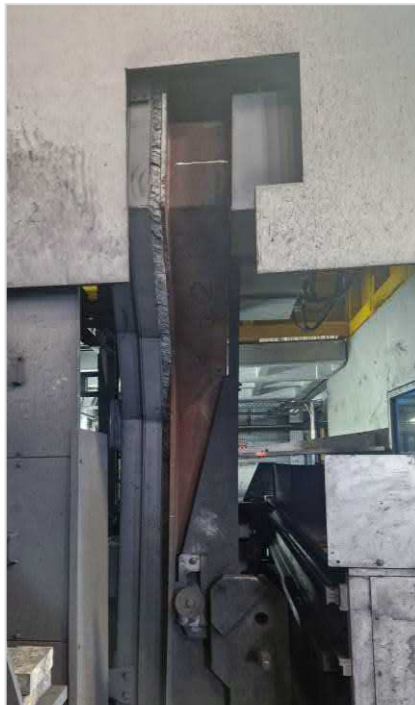
elektrisch beheizte Gießrinne
