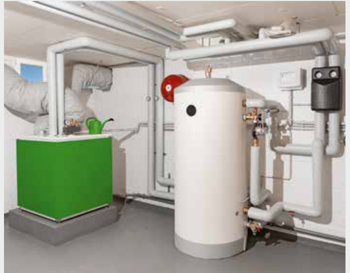
Wärmepumpen werden ein Aspekt bei der kommunalen Wärmeplanung sein.
