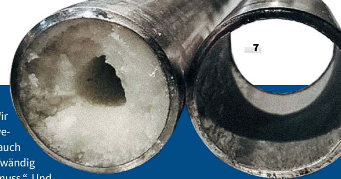
Ein Rohr vor und nach der Reinigung.
