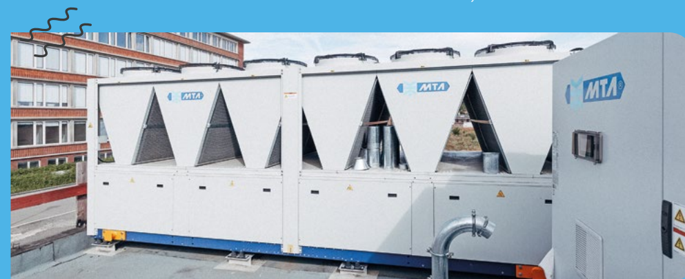
MVZ Kältemaschine auf der Energiezentrale
