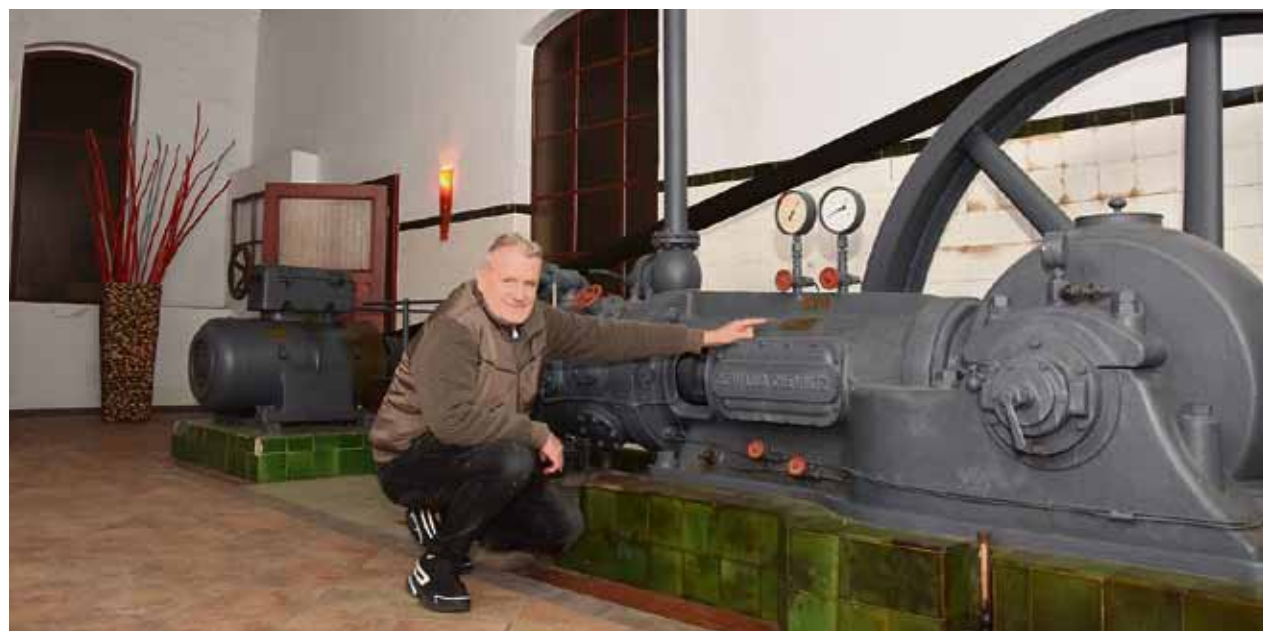
Mit dieser Dampfmaschine der GERMANIA Chemnitz wurde einst Strom erzeugt, der wiederum zur Herstellung von Eiswürfeln benötigt wurde, um Lebensmittel zu kühlen. Foto: IHK Chemnitz / K. Buschmann
