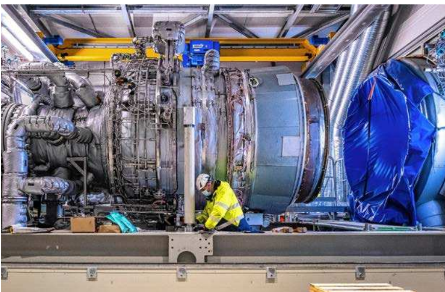
Die weltweit erste Gasturbine einer neuen und umweltfreundlichen Generation.
