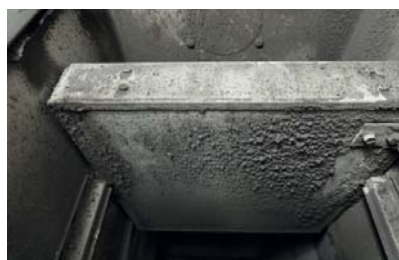
Blick in die asbesthaltige Brandschutzklappe
