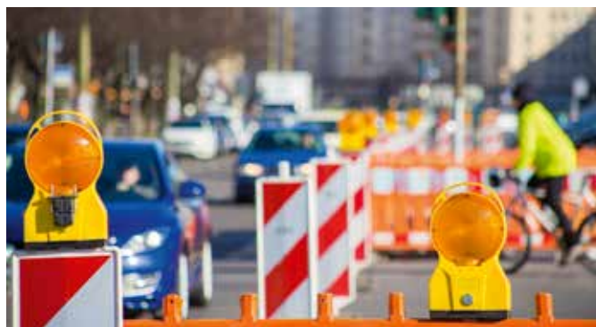
Im Schnitt hat sich die Baustellendauer in Osnabrück – verglichen mit dem Vorquartal – nochmals um 49 Tage erhöht.
