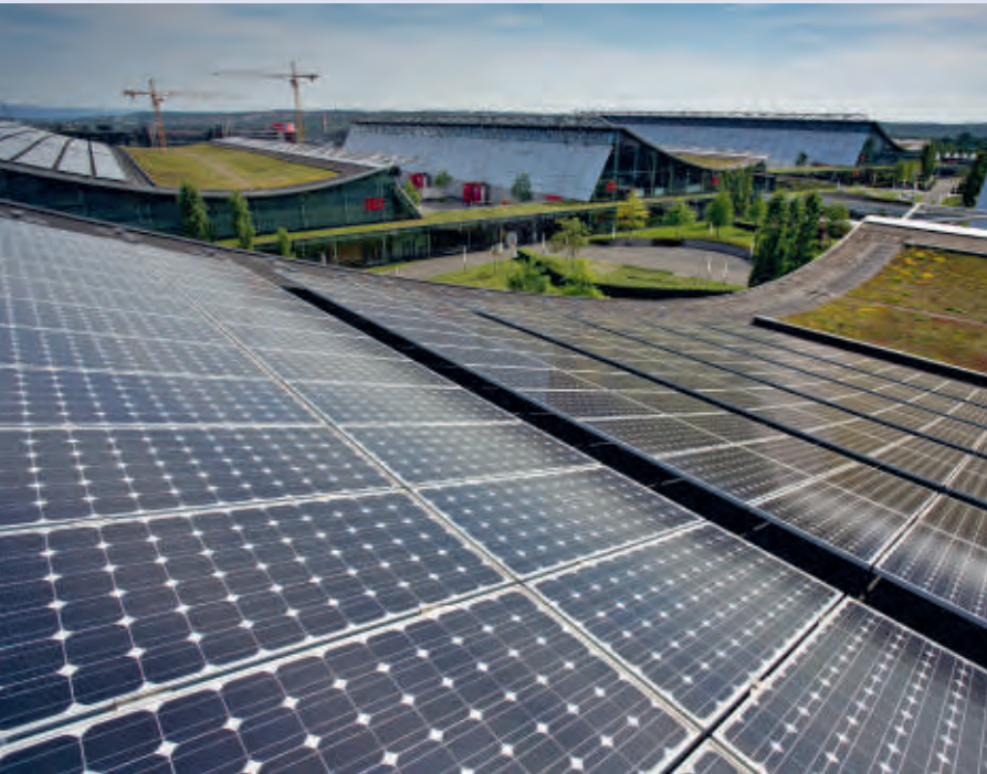
NAHAUFNAHME DER PHOTOVOLTAIKANLAGE auf den Dächern der Messehallen.
