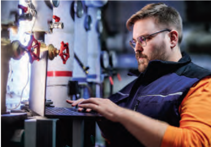
CEO und Gründer Maik Brinkmann bei der Analyse in einem Heizungskeller.
