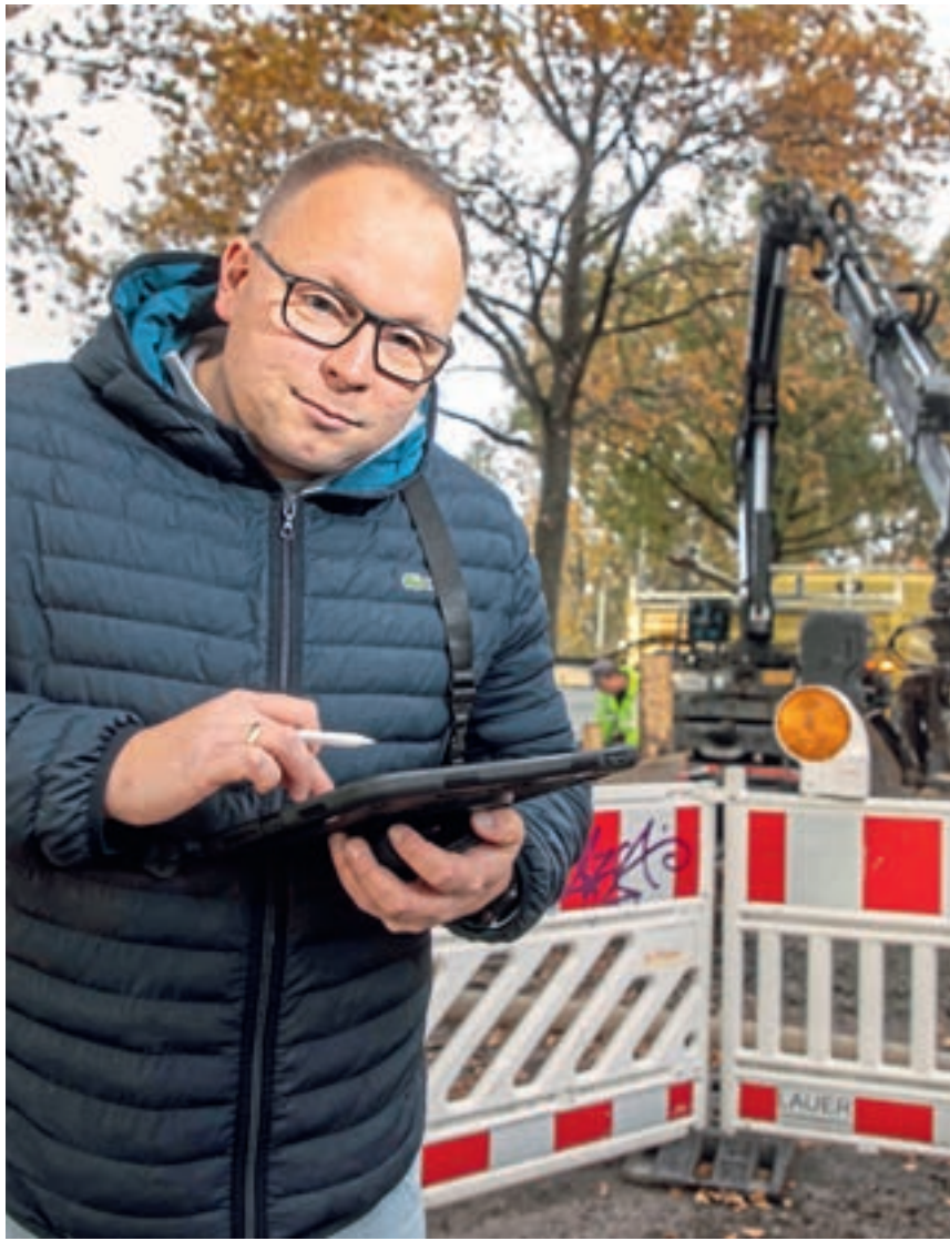
Bauleiter Manfred Uhlig vom Tief- und Rohrleitungsbauer Werner Pletz GmbH auf einer Baustelle
