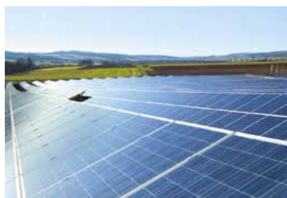
Strom aus der Region und für die Region: PV-Freiflächenanlage in Großenlütder-Müs
