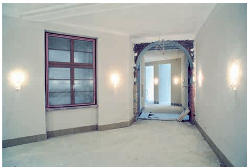
Übergang vom Alt- zum Neubau im Gebäude des BMU in der Stresemannstraße während der Baumaßnahme
