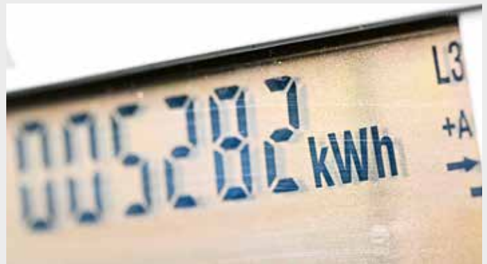
Die Digitalanzeige eines Stromzählers in einem Privathaushalt.
