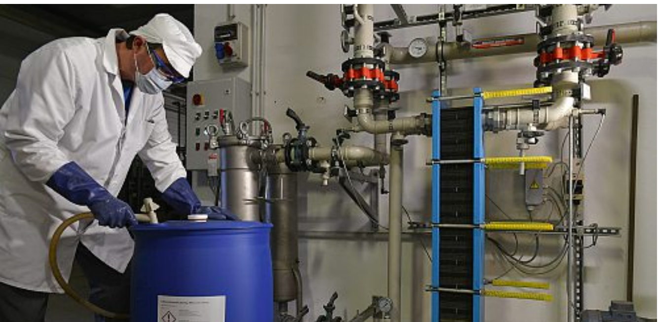
Mitarbeiter an einer Filtrationseinheit.
