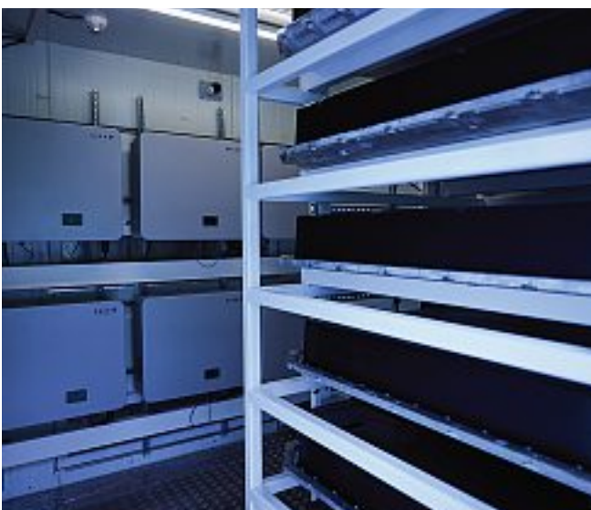
Speicher-Container von innen.
