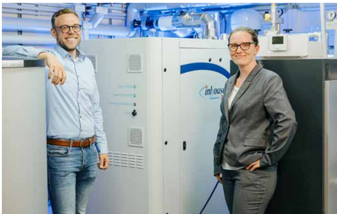
Mit dem neuen Brennstoffzellen-BHKW setzen Julia Brandt (Die Stadtfelder Wohnungsgenossenschaft eG) und Christian Rinne (DiLiCo engineering GmbH) ganz auf erneuerbare Energien.
