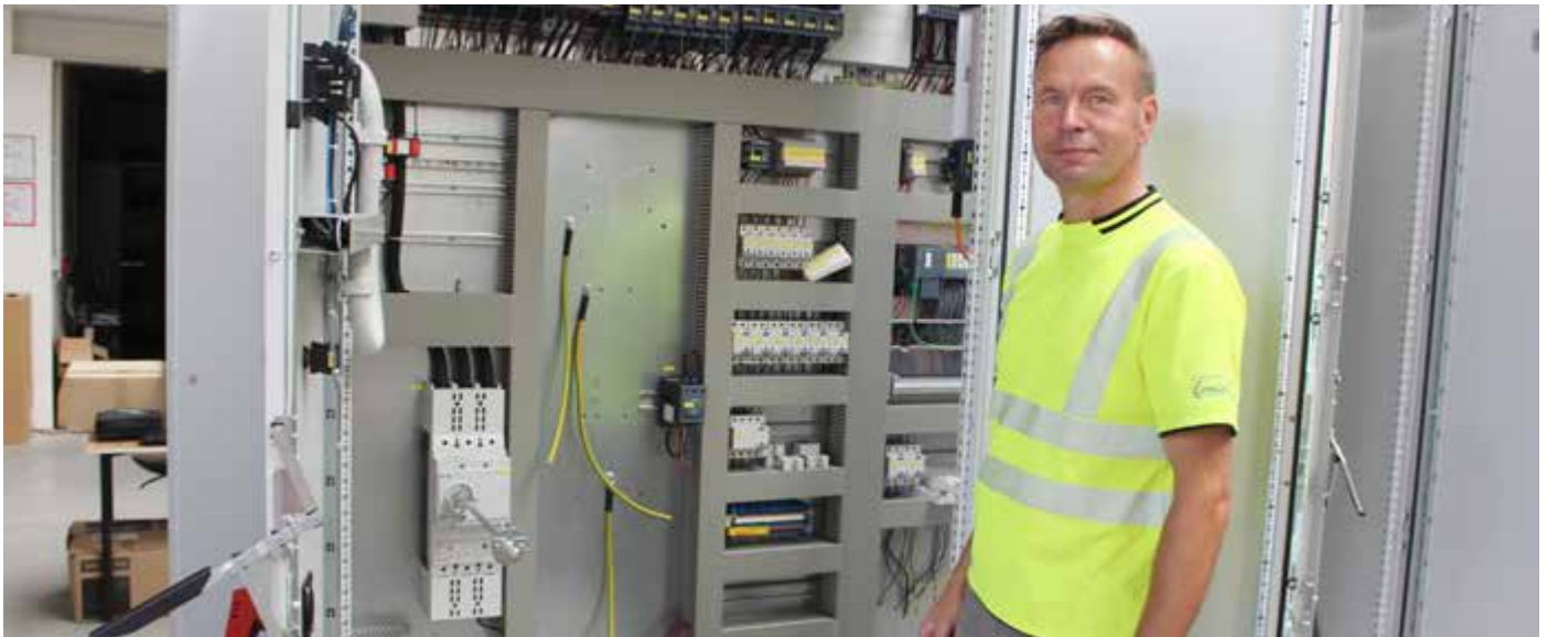
Thomas Woschei prüft eine Schaltanlage vor der Auslieferung nach China.
