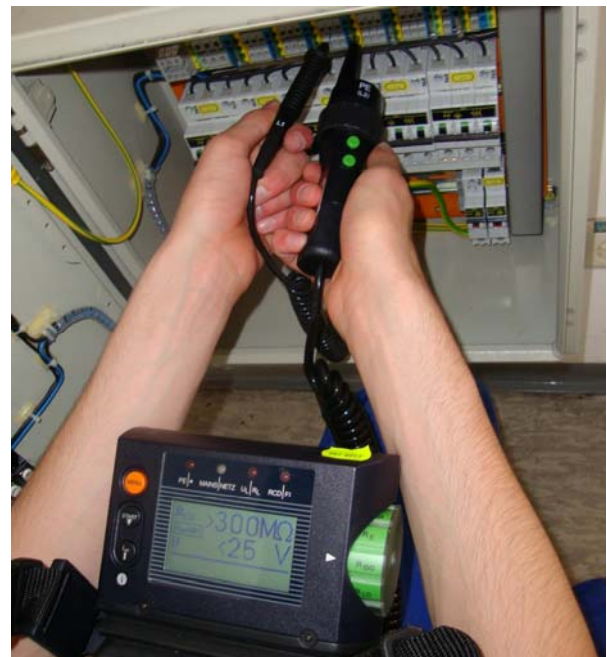
Abb. 1 1) : Wiederholungsprüfung an einer elektr. Anlage
