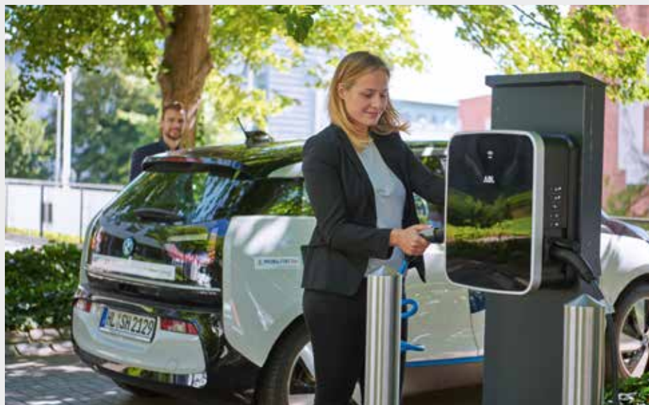
Auch das Aufstellen von Ladestationen kann gefördert werden.
