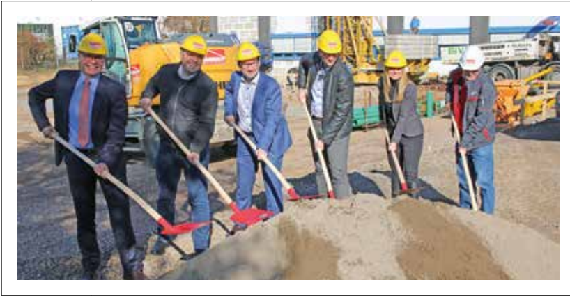
Am symbolischen Spatenstich nahmen (v. l.) neben dem Geschäftsführer Marcus H. Simon und Bürgermeister Dr. Marius Hahn auch Architekt Oliver Hamm (Hamm+ Partner), die beiden Prokuristen Marco Lehnert und Julia Bausch sowie Geschäftsführer Gisbert Busch von der Baufirma Dickopf teil.
