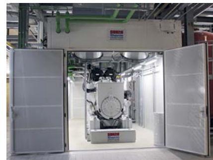
Foto: Stadtwerke Jena
