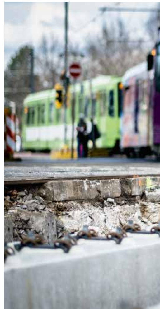
Die Anpassungsqualifizierung hat ihn weitergebracht: Zohir Al Saho bei der Arbeit auf einer Baustelle in Hannover.
