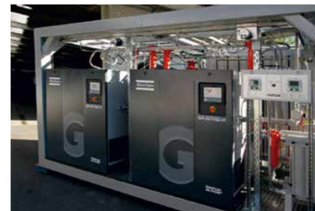
Skid-Druckluft- und Stickstoffanlage
