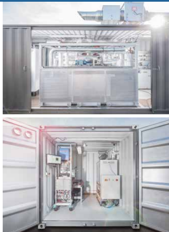
Dampf-Elektrolyse (oben) Off-Grid-Power Generator (unten)
