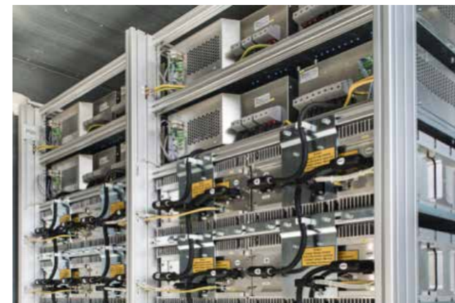
Energiespeicher Pulsstation Dresden Gruna
