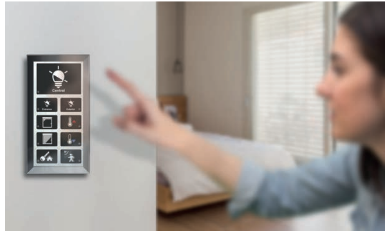
72 Beispiel zentrale Bedienung im SMART Zimmer
