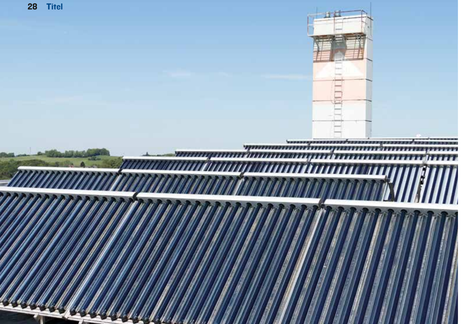
Die 400 Quadratmeter große Solarthermie-Anlage der Firma Steinbach & Vollmann entstand in Kooperation mit der Hochschule Düsseldorf.
