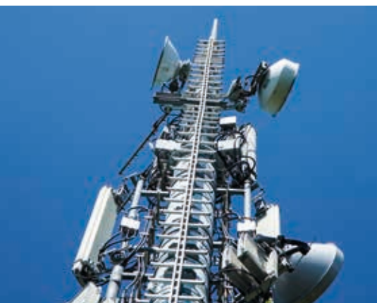
LTE-Antenne der Vodafone GmbH.
