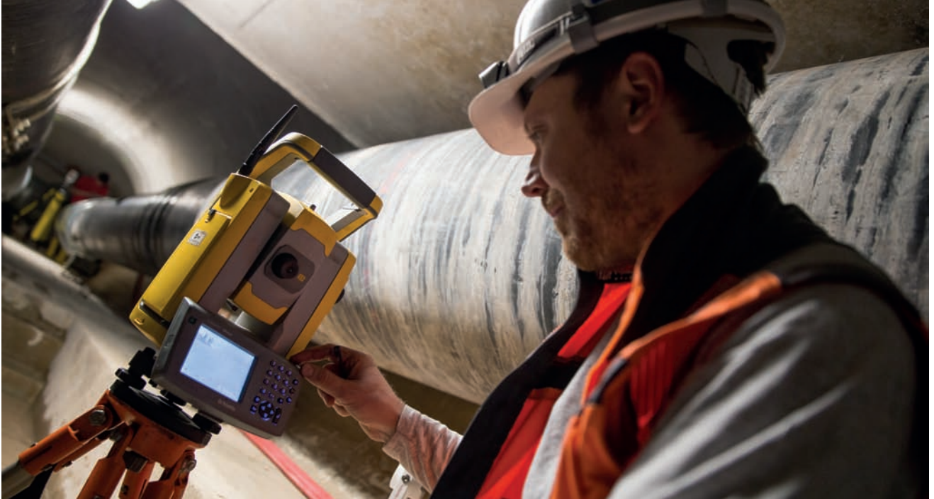
Die Vermesser von PV Anspenger untersuchen die Risse im 260 Meter langen Fernwärmehöhle, durch die das Rheinwasser eindringt.
