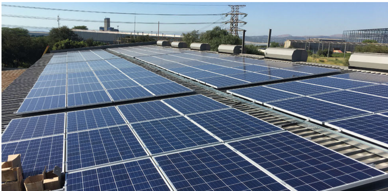
Das Ergebnis des Crowdfunding-Projekts: Die aufgestellte Photovoltaik-Solkraftanlage auf den Dächern der Tyre Corporation in Südafrika. Foto: Soventix GmbH
