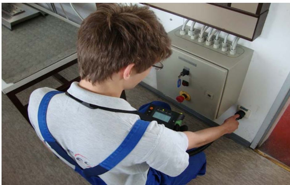
Messung an einem Unterverteiler
