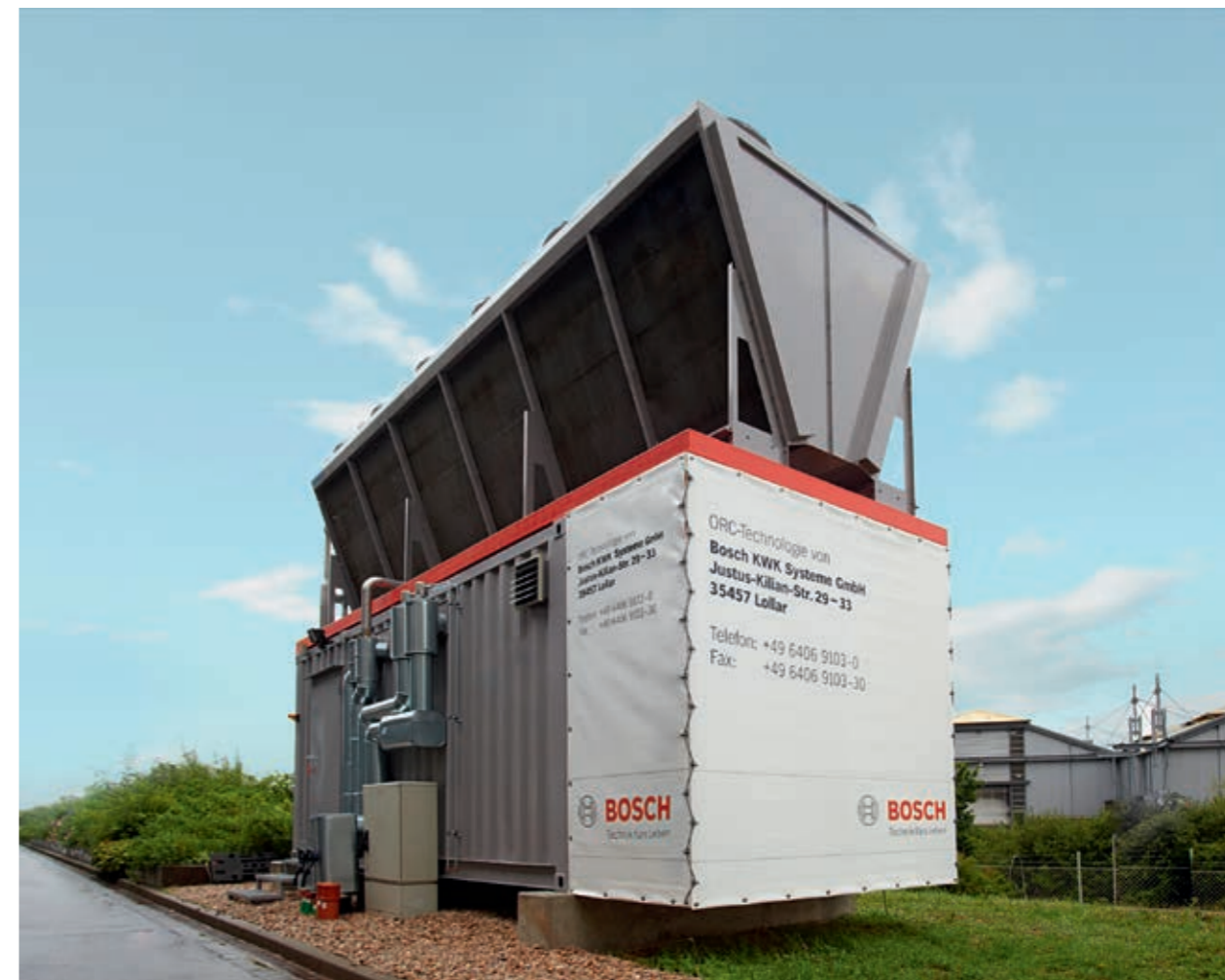
ORC-Anlage auf der Rhein-Main Depone GmbH (RMD) in Flörsheim-Wicker. (Bild: Bosch KWK Systeme GmbH)
