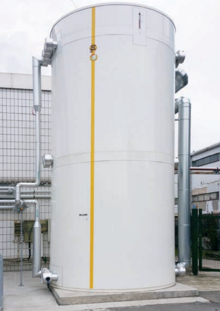
Wärmespeicher zur Speicherung von Abwärme aus einer Klimaanlage in einer Fleischerei (Bild: Haase Tank GmbH)
