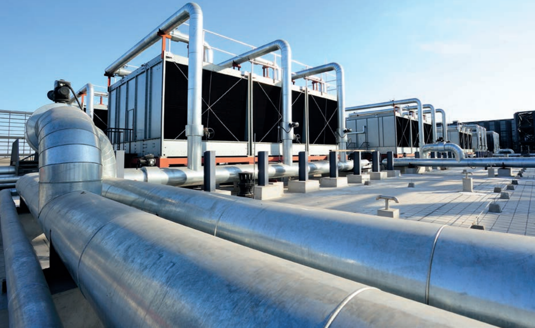
Kühlanlagen auf dem Dach eines Industriegebäudes (Bild: iStock by Getty Images)
