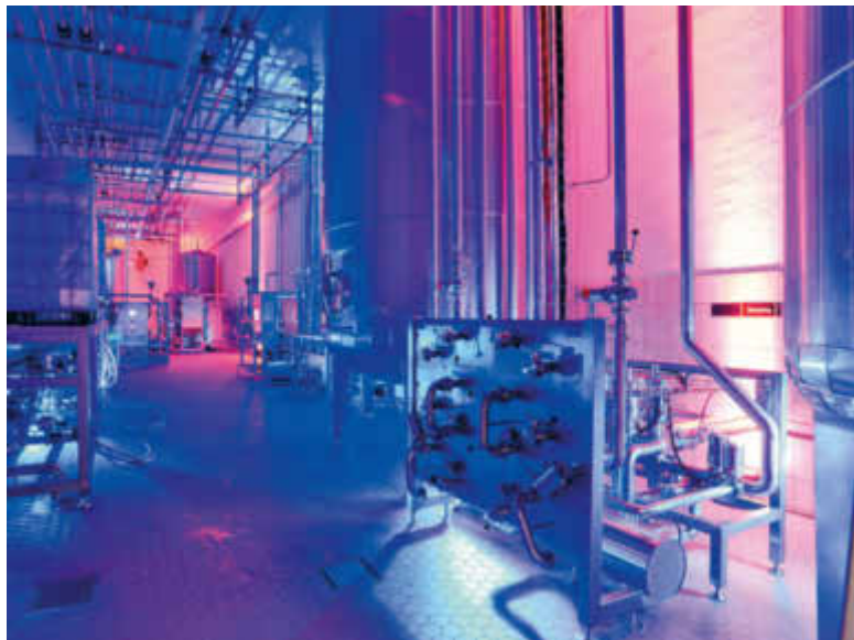
Die neue Biermischanlage der Fürstenberg Brauerei.
