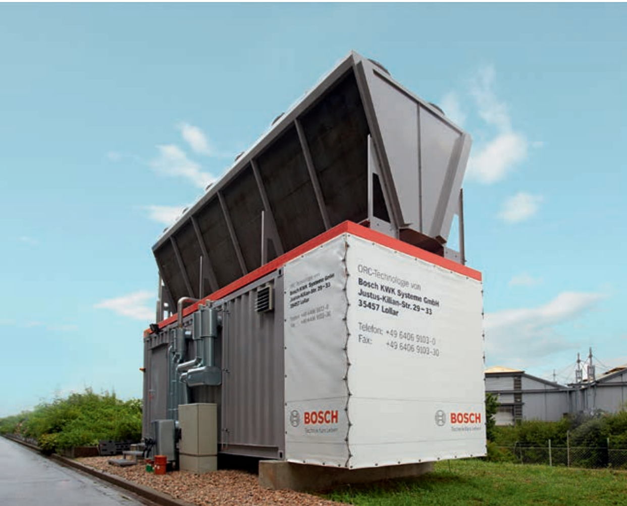
ORC-Anlage auf der Rhein-Main Depo-nie GmbH (RMD) in Flörsheim-Wicker. (Bild: Bosch KWK Systeme GmbH)
