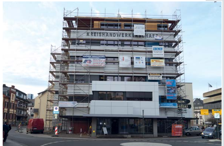
Nach 38 Jahren muss das Gebäude der Kreishandwerkerschaft Limburg-Weilburg an der Schiede im Jahr 2015 dringend außen saniert werden (IHK Limburg)
