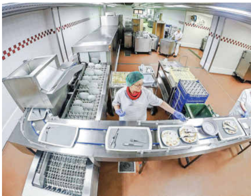
Eine Spülanlage von Hobart, die in einem Krankenhaus im Einsatz ist.
