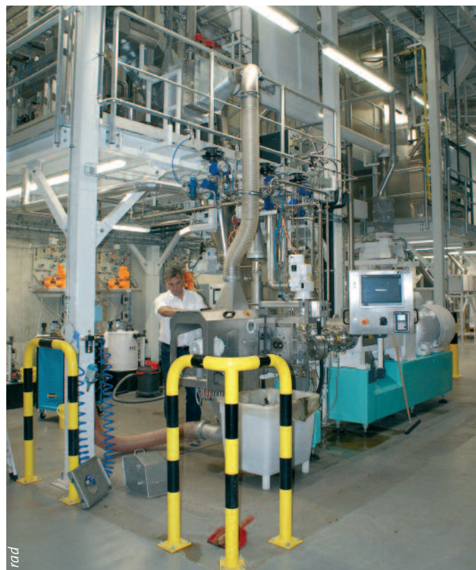
Das Herzstück der neuen Produktionsanlage, der Extruder.
