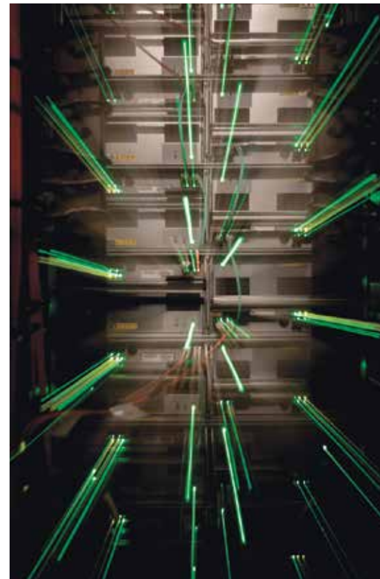
Hochprofessionelle Datacenter-Lösungen im Einsatz
