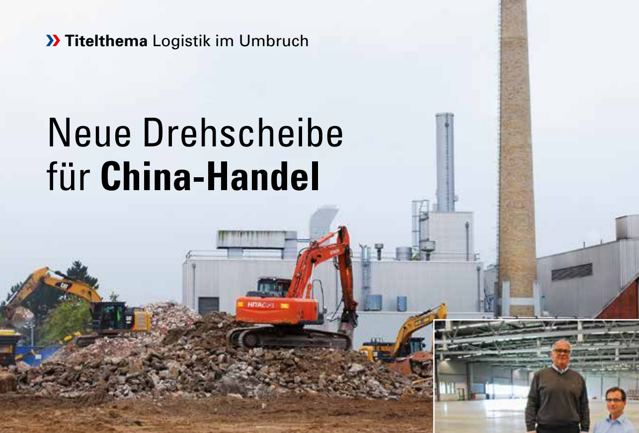
Links: Abrissarbeiten auf dem früheren Druckereigelände; unten: Investor Gustav Jürgen Tietje mit seinem Sohn Carsten Tietje in der Halle W
