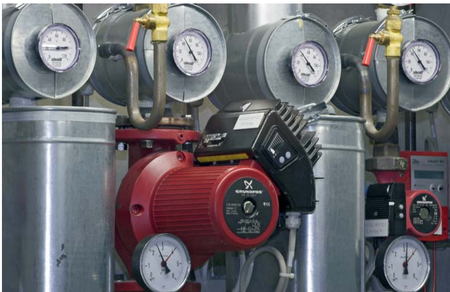
Heizungsverteiler für unterschiedliche Heizregelkreise
