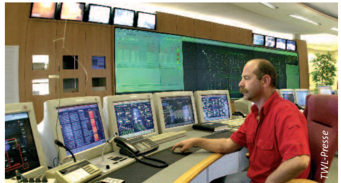
Die Verbundleitwarte der TWL AG in Ludwigshafen ist die Kommandobrücke des Unternehmens.
